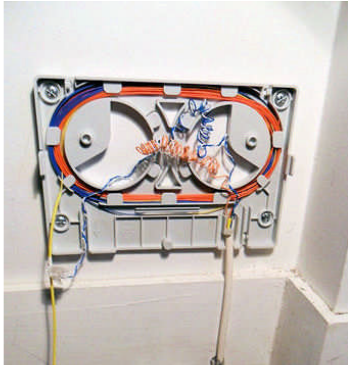
Photo 5: ONT Unit Wall plate
